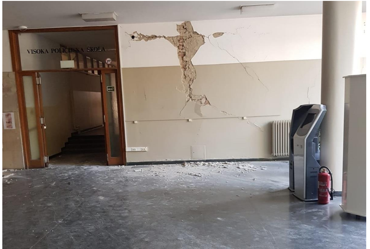
U predvorju Visoke policijske škole sa zidova je pala žbuka i mramorne ploče (na slici dolje lijevo), školska ploča u predavaonici 206, dok je u ostalim prostorijama većinom pala žbuka sa zidova
