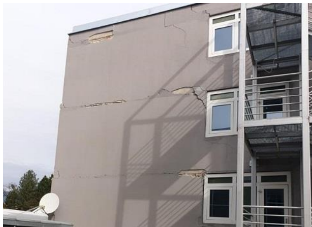
Znatna oštećenja od potresa, osim u unutarnjim prostorima, vidljiva su i na pročelju same zgrade Visoke policijske škole
