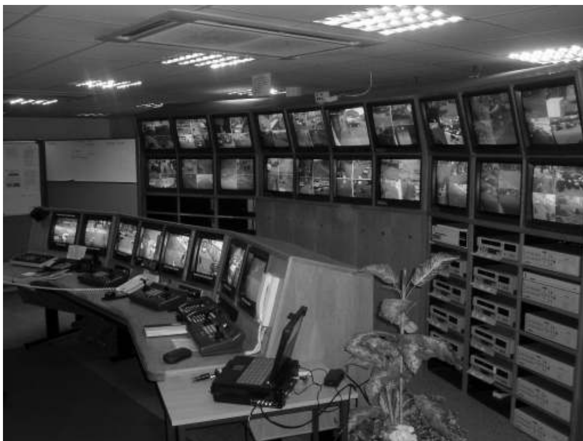
Slika 1: Izgled CCTV centra u gradu Granthamu
