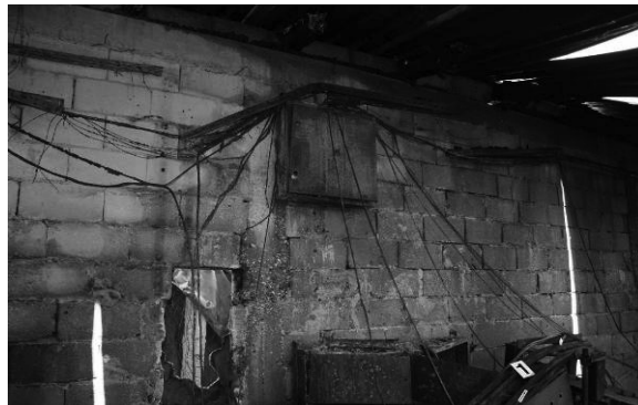
Slika 4: Metalne kanalice s kabelima
