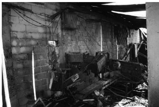
Slika 1: Električna instalacija u opožarenoj prostoriji
