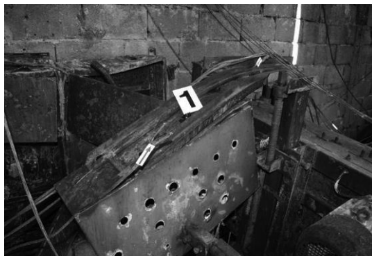
Slika 2: Kabel s tragovima termičkog oštećenja i prekida
